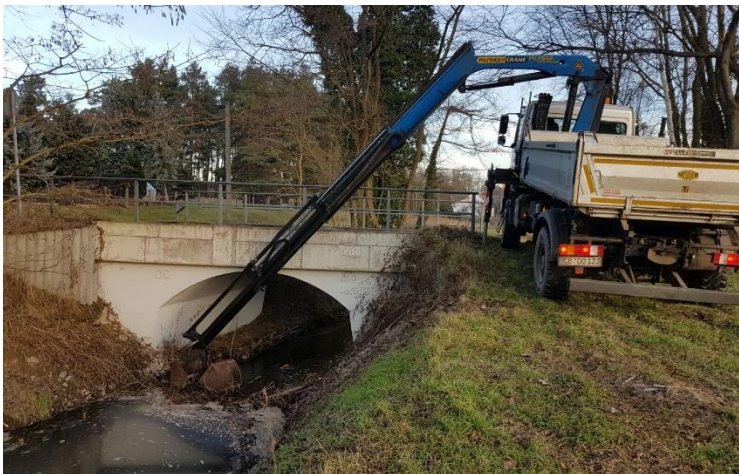
Punktuelle Grundräumung/ Abflusshindernisse
