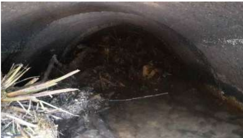
ein vom Biber zugestopfter Rohrdurchlass im Klosterbuschgraben Guben
